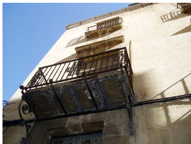
Estado de bandejas en balcones
