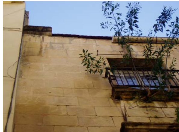
Oquedades y vegetación por humedad
