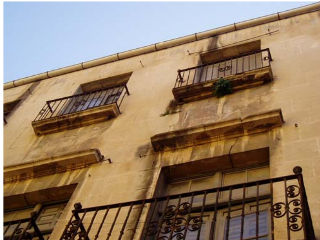
Escorrentía y lesiones mecánicas
